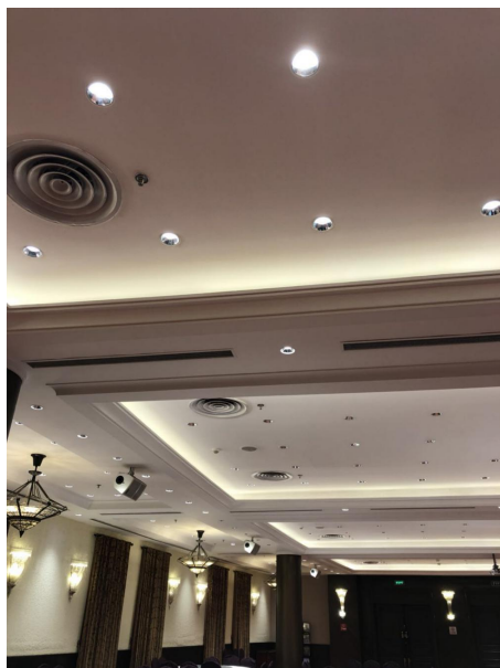
东方明珠塔将现场灯光换成节能 LED 灯
